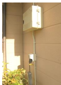
□夜間電力を活用した充電設備
