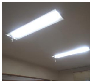
□本社事務所に設置したLED照明器具
