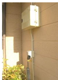
□夜間電力を活用した充電設備
