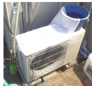
□気化熱利用のエアコン室外機の冷却装置
